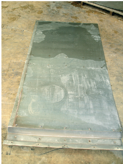
Fassadenbleche stark verunreinigt und korrodiert. Laut einem Gutachten sind die Bleche "nicht mehr zu retten".
